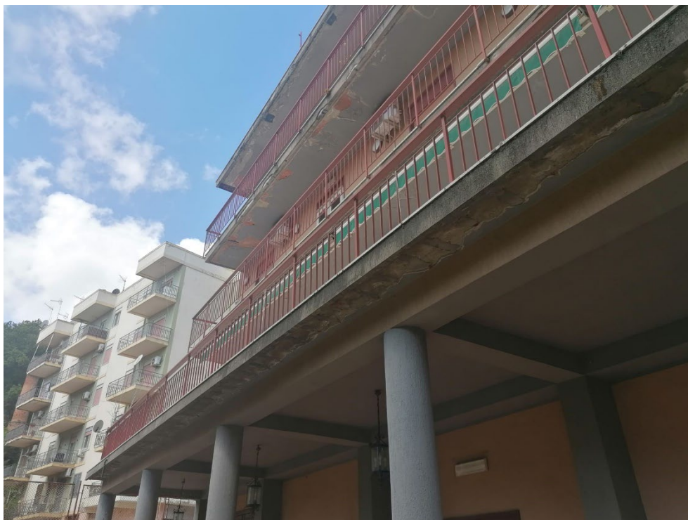
Figura 12 - Foto degrado finiture
